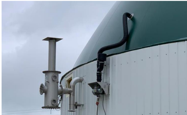
Fotografia 3.3 - Exemplo de válvula de sobrepressão e janela de observação instalados num reator.
