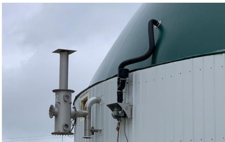
Fotografia 3.8 - Exemplo de uma válvula de sobrepressão e ventilador de ar instalados num reator.
