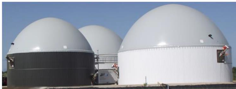
Fotografia 3.2 - Exemplo de reatores numa unidade de biogás (tecnologia AGF).
